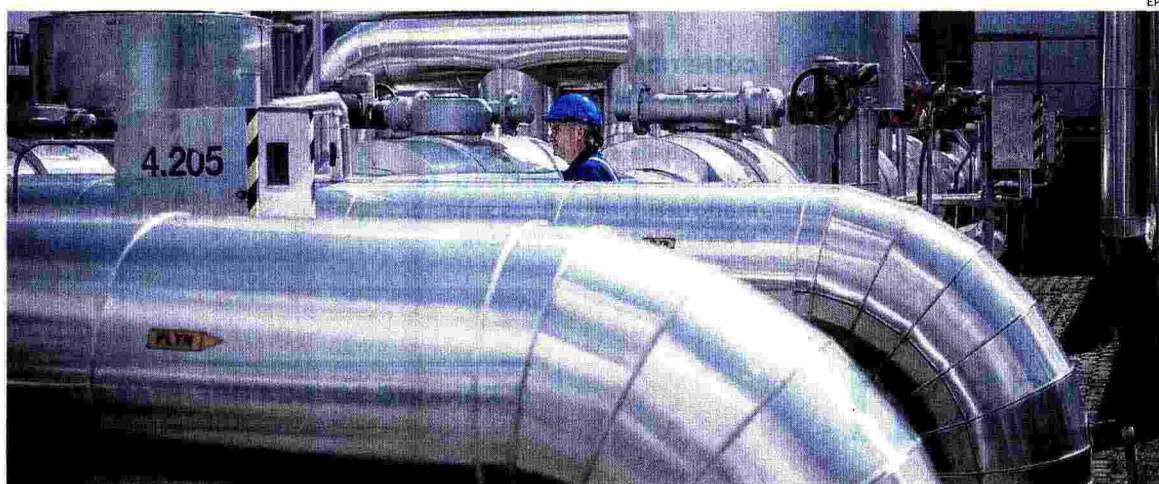
Infrastruttura strategica. Un sito sotterraneo di stoccaggio del gas nei pressi di Haje u Pribami, nella Repubblica Ceca
